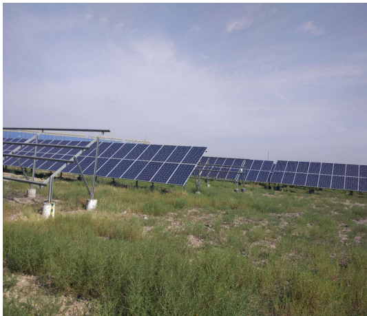
光伏电板区域
